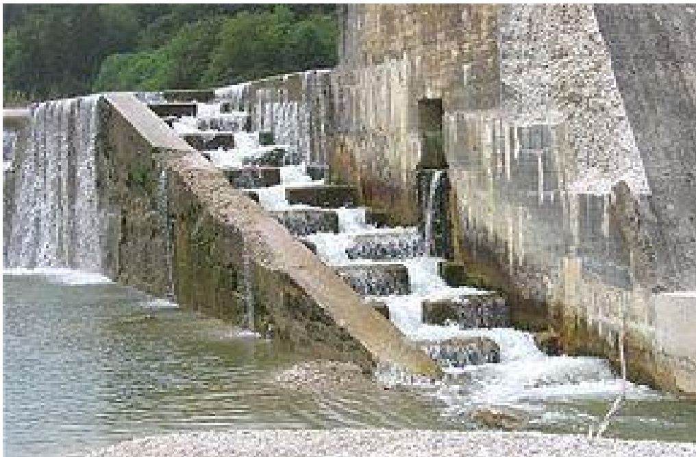
Figura 7: Passaggio per pesci realizzato su una traversa esistente.
