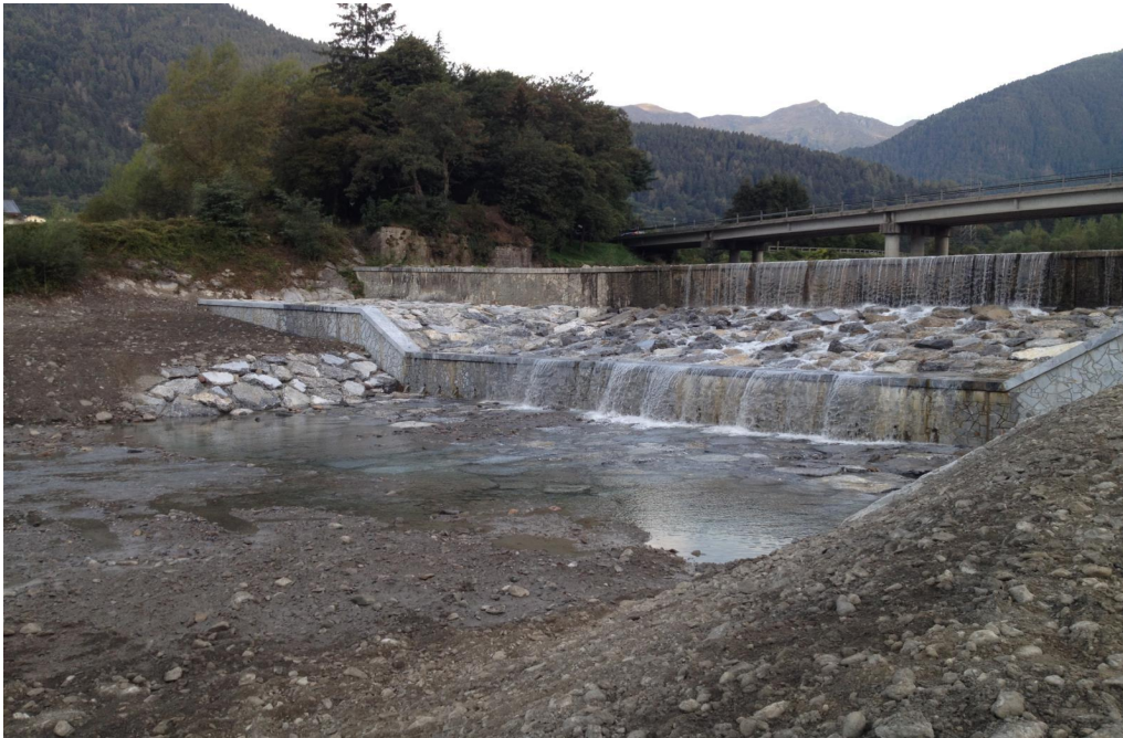
Figura 6: Briglie su un corso d'acqua, munite di soglie per la dissipazione dell'energia cinetica delle piene e con difese spondali in massi da scogliera.
