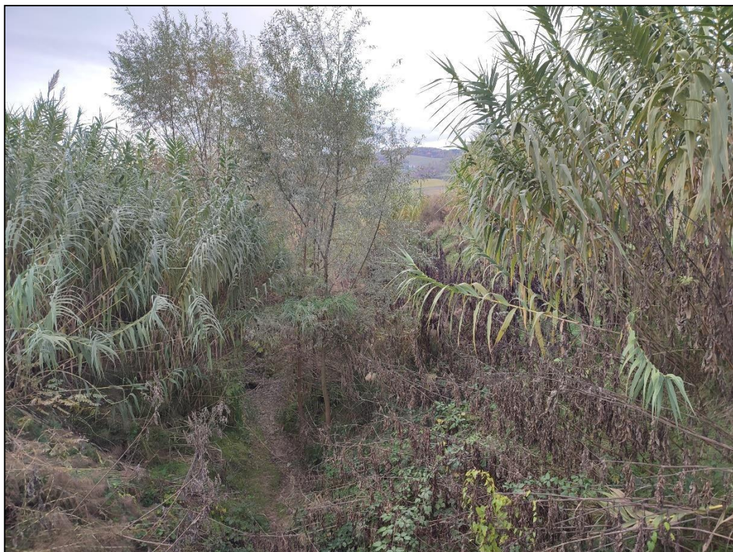
Figura 13: vista della vegetazione sul rio San Pietro a valle del ponte SP25
